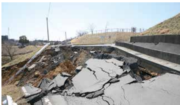
道路は至るところで亀裂が走り、中には陥没してしまっている箇所もある。(写真提供=登米市)
